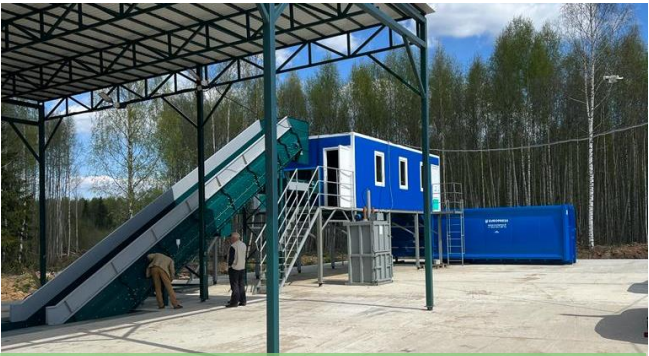
Комплекс по сортировке ТКО в Пестовском округе
